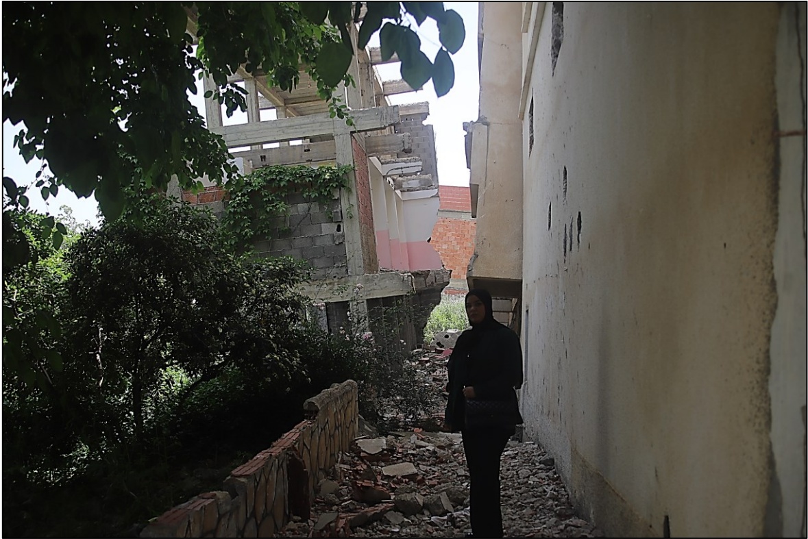
Figure 5.14 Dégâts du séisme du 07/08/2020 (Source : Auteure 2020-2025)
