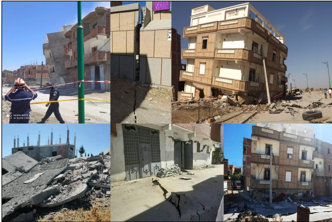
Figure.5.17 Impacts du glissement de terrain sur le bâti et les constructions (séisme du 7 août 2020)
