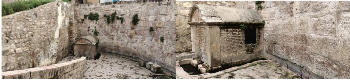
Figure 6.38. Présence de végétations sauvages au niveau des murs
