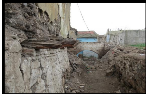
Figure 6.74. Vue sur une rue en état dégradé
