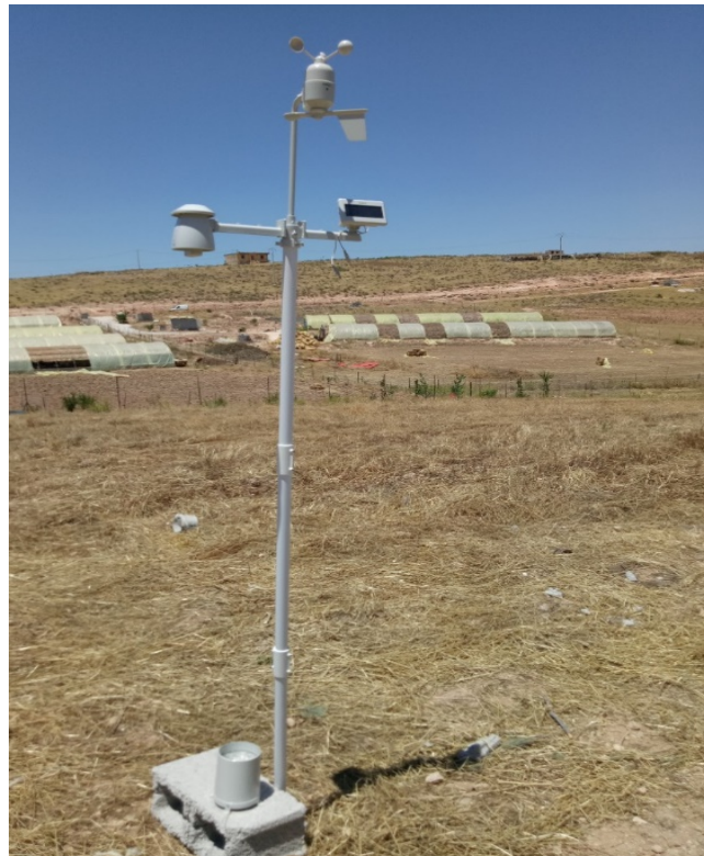
Figure 5. 19 : Installation extérieure de la station météo
