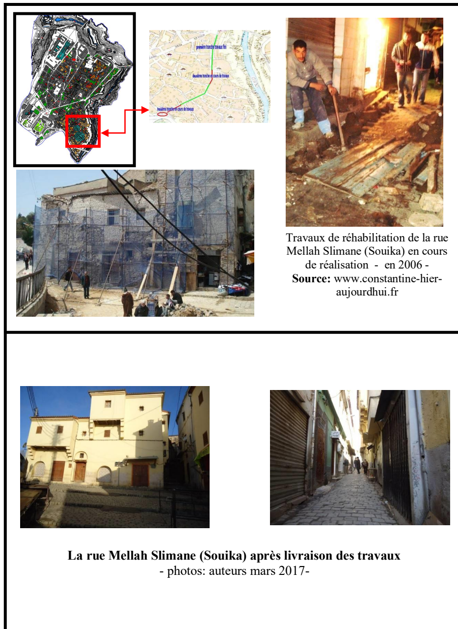
Figure 5.6: Réhabilitation de la rue Mellah Slimane axe principal de la Souika: une expérience isolée!
