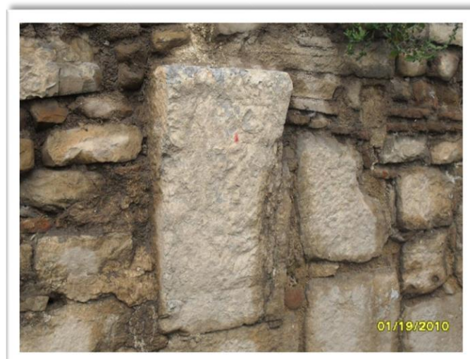
Figure 19 : Pans de mur Source : Photos P.P.S.M.V.S.S Constantine, 2010.
