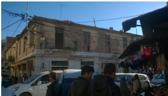
Figure 56 Immeuble en mauvais état abandonné par les propriétaires et le RDC toujours occupé par le commerce
