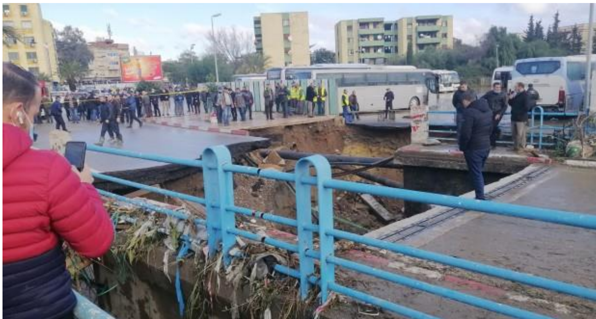
Figure 8.7 : Oued El Kantara à Jijel, où des dégâts occasionnés par des pluies torrentielles suite à l'obstruction de la galerie bétonnée canalisant le cours d'eau. (Source : elmoudjahid.com, 2020)
