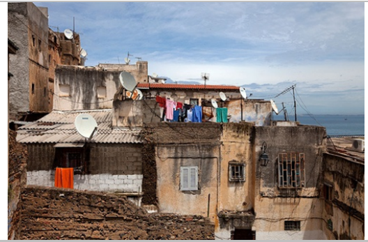
Photo 79 : Vue sur les façades des maisons non entretenues dans la haute casbah.
