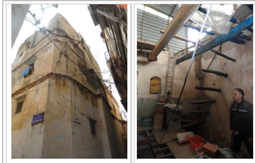
Photo 92: vétusté et dégradation des constructions de la casbah d'Alger
