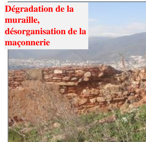
Figure 156 Dégradation de la muraille, due à des phénomènes combinés, l'action de l'eau, action des sels, action des intempéries, poussée des végétaux. Source : auteur
