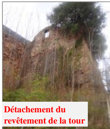
Figure 180 Détachement des revêtements extérieurs, la tour T5. Source : auteur.
