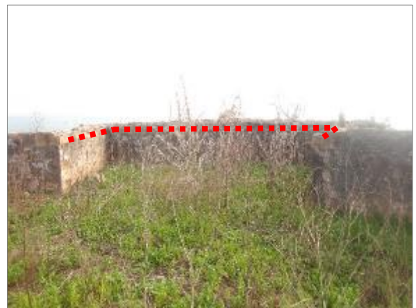
Figure 187 Vue intérieure, une pathologie liée à la dislocation de la maçonnerie au niveau du parapet, La tour T7. Source : auteur.
