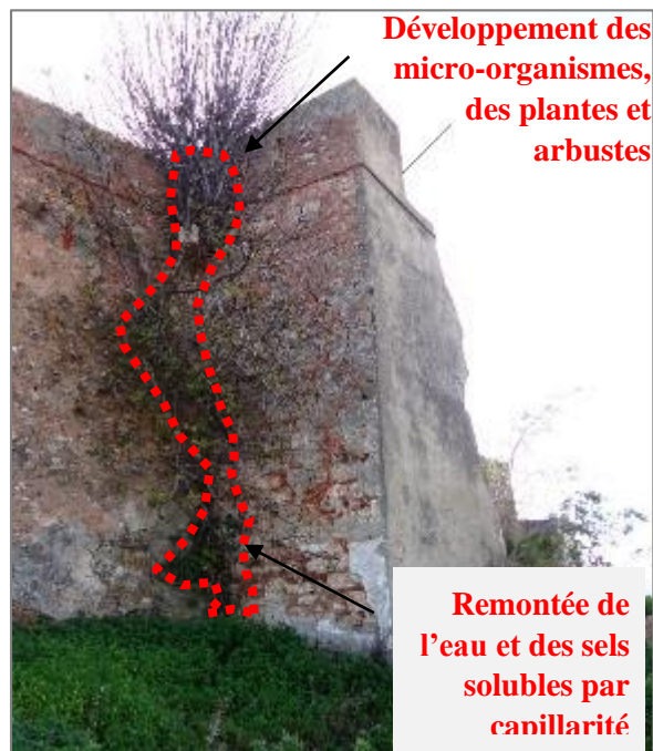
Figure 175 Pathologies dues à l'humidité et à l'action de la végétation, la tour T1. Source : auteur.
