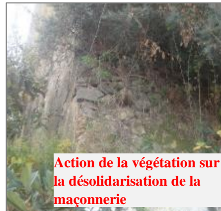
Figure 181 Les effets de la végétation sur la désolidarisation de la maçonnerie et la déstabilisation des murs, la tour T5. Source : auteur.
