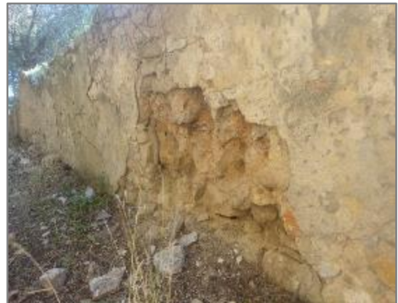
Figure 166 Action chimique et mécanique des racines de plantes sur la déconsolidation de la muraille. Source : auteur
