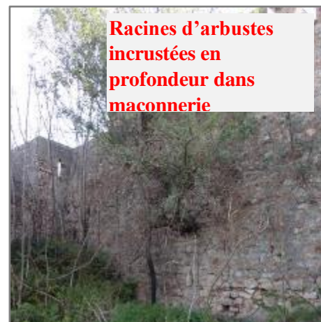
Figure 158 Humidité et sels solubles suscitant le développement des racines d'arbustes dans les murs induisant l'éclatement des matériaux. Source : auteur
