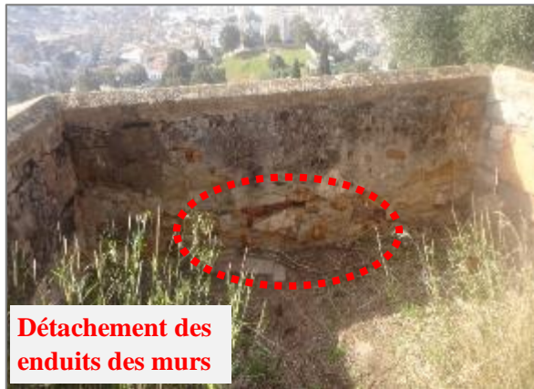
Figure 188 Décollement des enduits des murs, le bastion T8. Source : auteur.
