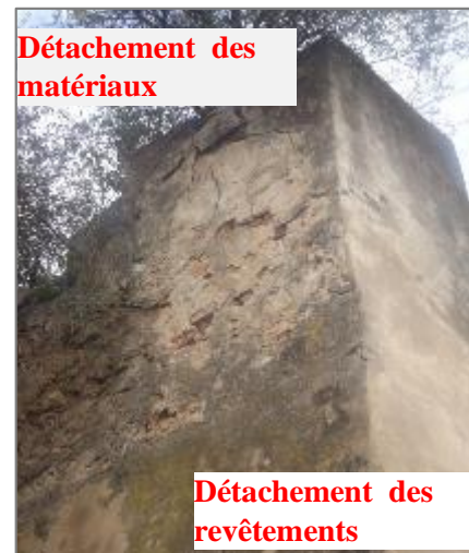
Figure 184 Dégradation et décollement des enduits et des mortiers et détachement de la maçonnerie, la tour T6. Source : auteur.
