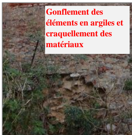
Figure 157 Détérioration des liants à cause du bombement des éléments en argile et de la cristallisation des sels favorisant un craquellement des matériaux. Source : auteur
