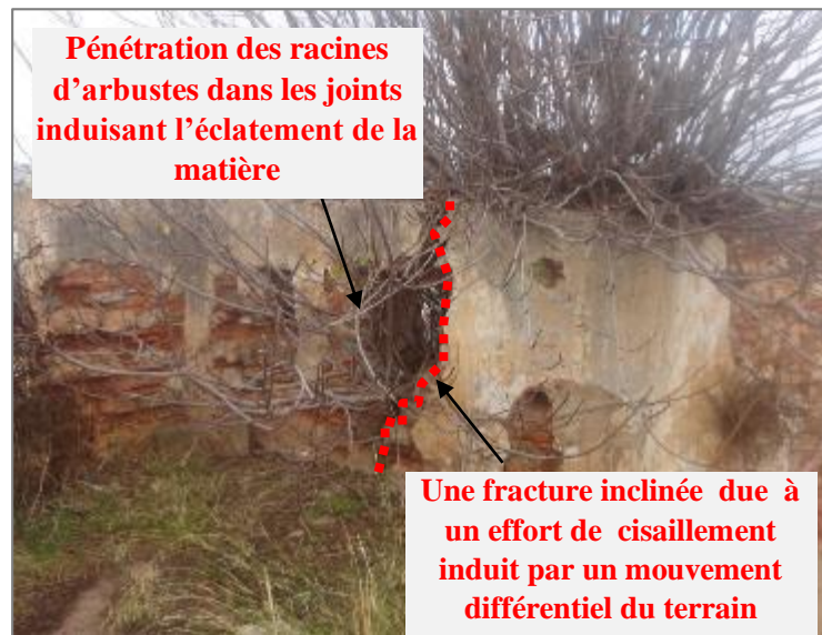
Figure 176 Une Pathologie combinée d'un mouvement différentiel des fondations et de l'action de la végétation dans la maçonnerie, la tour T1. Source : auteur.
