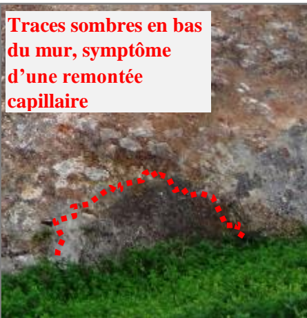
Figure 155 Remontée capillaire de l'eau et des sels solubles. Source : auteur
