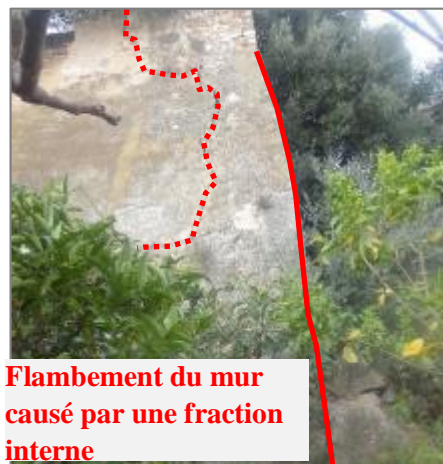
Figure 182 Flambement du mur causé par une fraction verticale interne due à l'excès de compression, la tour T5. Source : auteur.
