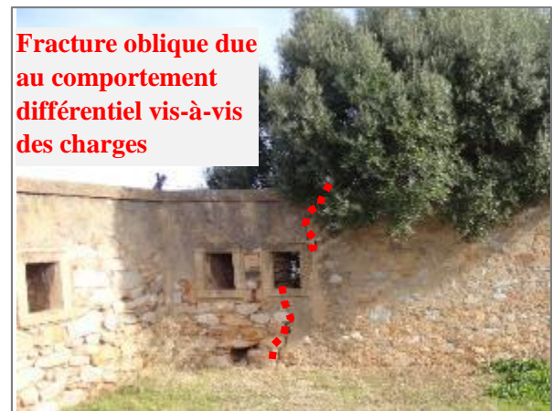
Figure 179 Des fractures verticales causées par une différence de la distribution des charges entre le mur Ouest et le mur transversal, la tour T3. Source : auteur.
