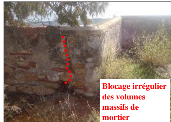
Figure 189 Une lézarde oblique de fraction dont l'origine remonte à l'instabilité de l'assise et au mouvement du terrain, le bastion T8. Source : auteur.
