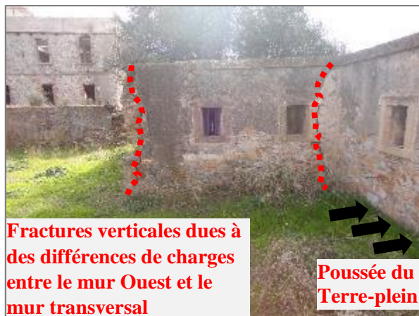
Figure 178 Un schéma de fracture oblique se rapportant à un comportement différentiel des murs vis-à-vis des charges et à un tassement différentiel de l'assise, la tour T3. Source : auteur
