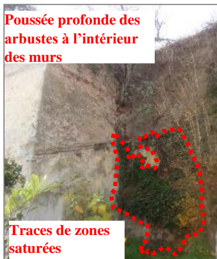
Figure 183 Pathologies liées à la remontée de l'eau et aux effets destructeurs des plantes, la tour T6. Source : auteur.
