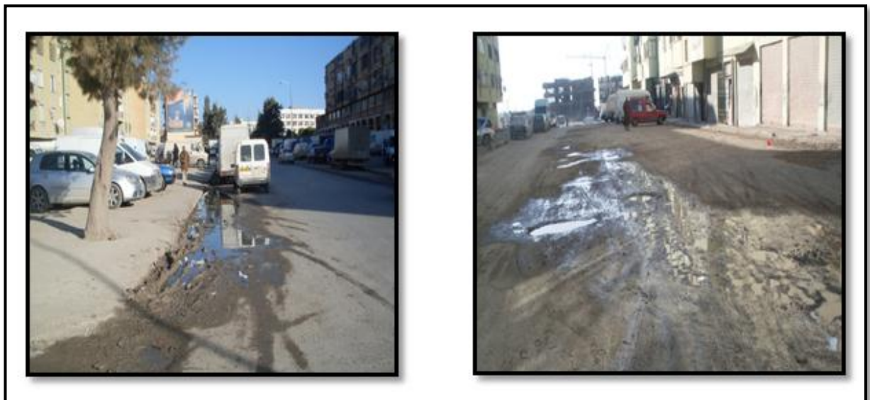
Photo N° 01 : AIN ARNT, Un réseau d'assainissement dégradé et un système d'évacuation dépassé due au manque des avaloirs fonctionnels.
