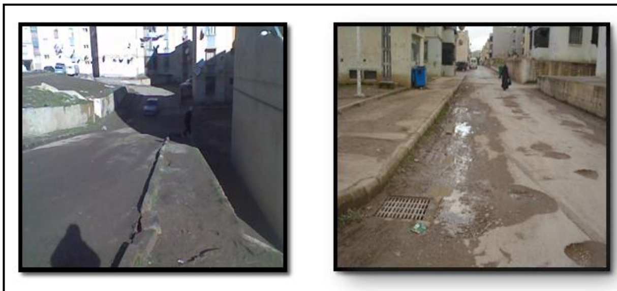
Photo N° 05 : AIN ARNT, Des voies carrossables en état de piste, des cheminements piétonniers dégradés.
