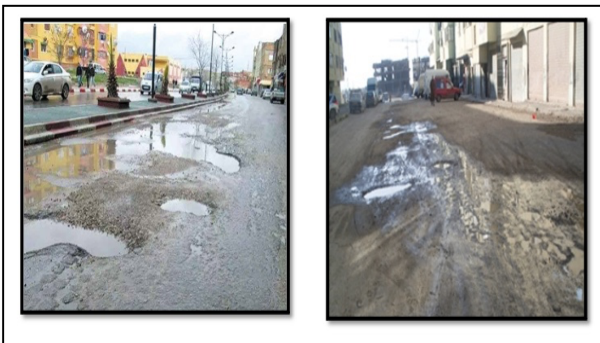
Photo 01 : La dégradation du réseau d'assainissement à Ain Arnat.
