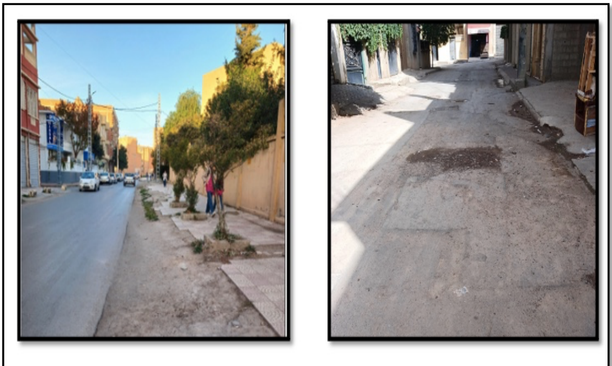
Photo 02: la dégradation de la voiries et des cheminements piétons à Ain Arnat.
