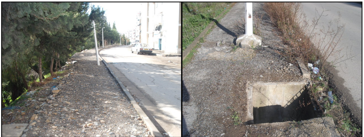
Image 11 : Photographies de trottoirs en mauvais état.
