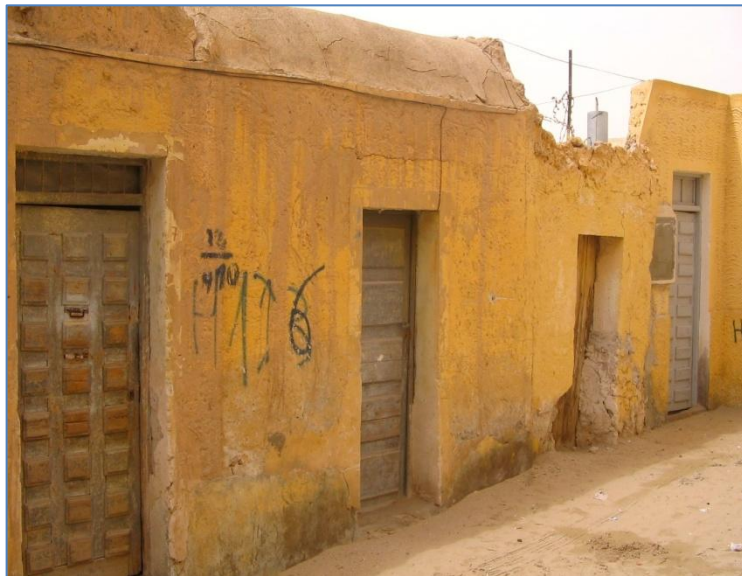
Photo n°74 : exemples des maisons ont préservé leur cachet traditionnel mais en état de dégradation Source : Auteur, 2012.
