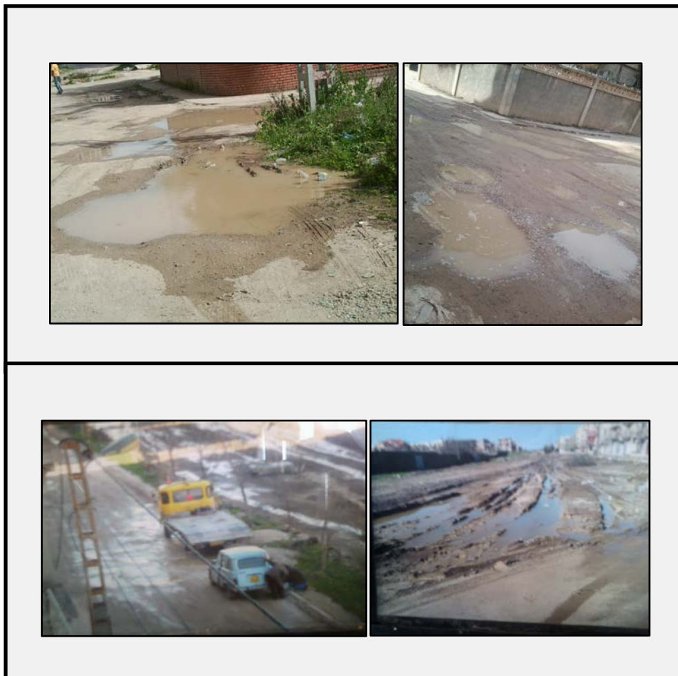
Photo n°81, 82,83 et 84: formation des cuvettes vu l'absence des avaloirs (par l'auteur 2013)
