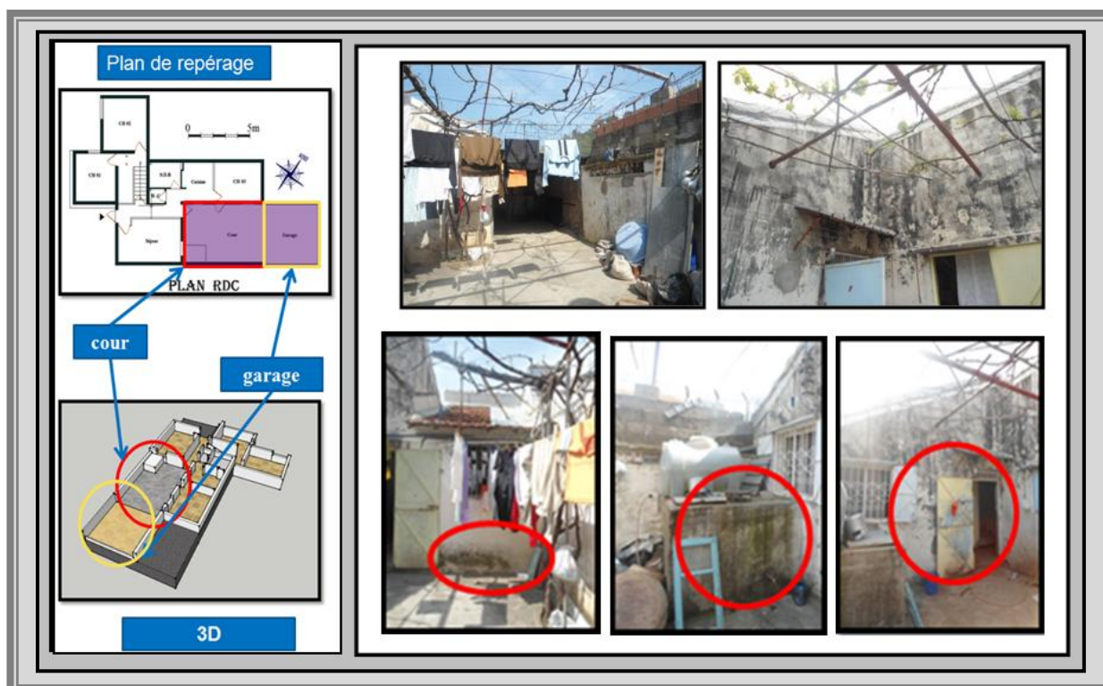
Figure. n°47: Dégradation et pathologies au niveau de la cour et de garage. La cour et le garage présentent des signes de dégradation superficielle.
