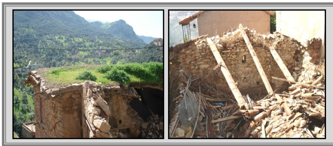
Photo. n°9: Maisons rurales traditionnelles kabyle en état de dégradation avancée.
