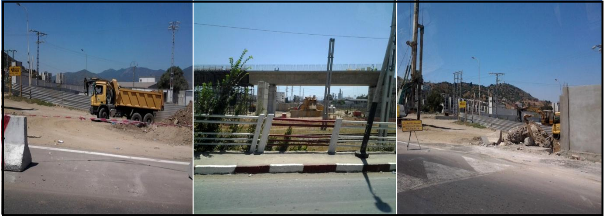
Photos 20: Travaux de réalisation d'un viaduc situé à l'entrée Sud de la ville d'Annaba (Source : Prises par l'auteur)
