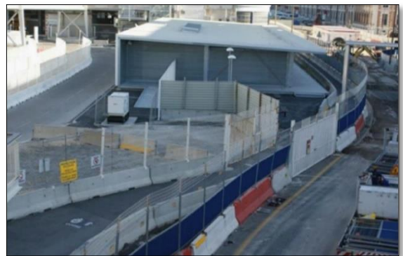
Figure 6.8. Système de barrières séparant l'emprise portuaire de la ville.
