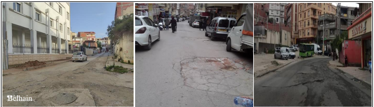
Figure 3.44. Voies en état dégradé. Photos prises par l'auteur des quartiers : Belhain, Camp Chevalier et Ben Achour (2021).
