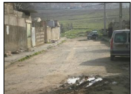
Photo 60 : état de la voirie
