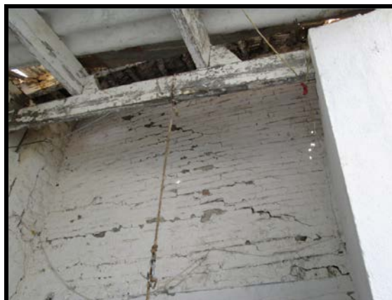
Photo 4.22 : Fissuration du mur sous l'effet des conditions climatiques.
