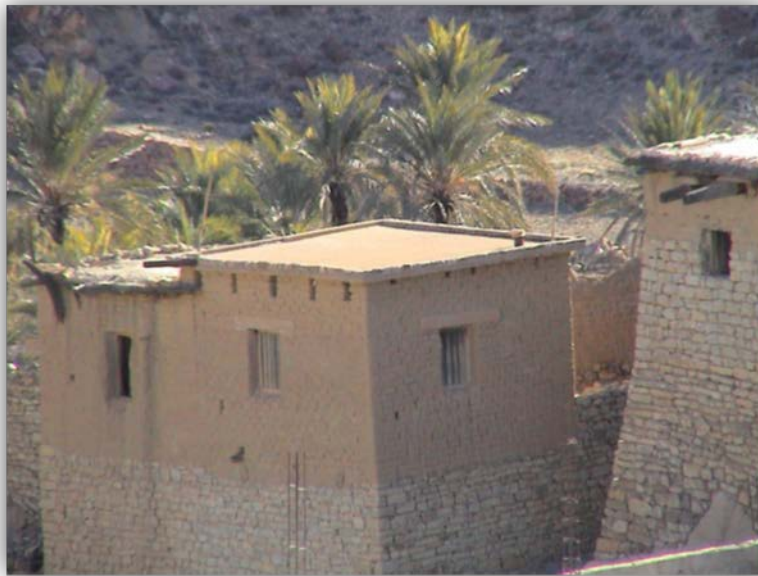
Photo 1.4 Exemple d'association de deux matériaux naturels et traditionnels : Toub et pierre, à Amentane Sud des Aurès
