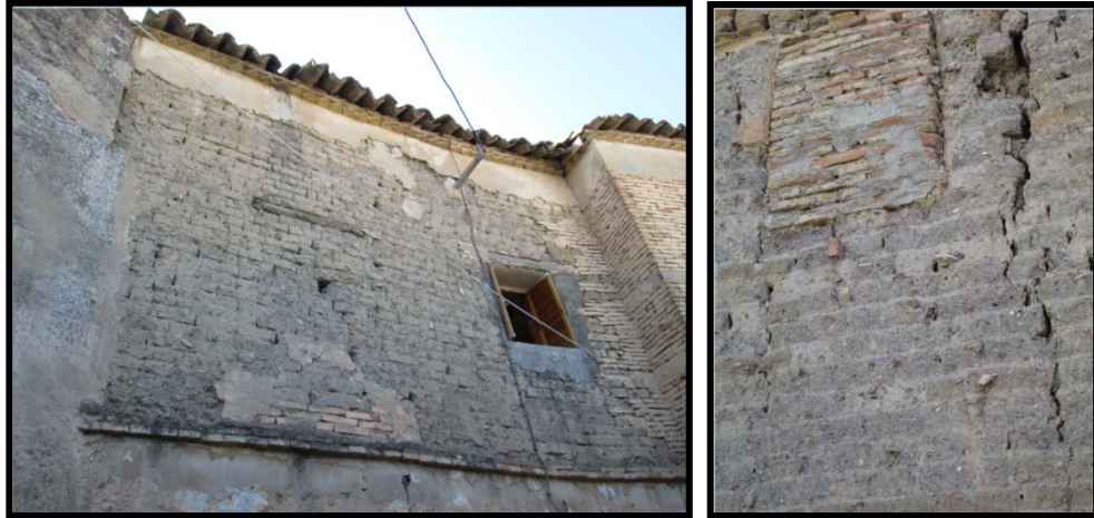
Photo 4.18 : Décollement de l'enduit et décomposition de la terre utilisée sous le toit.
