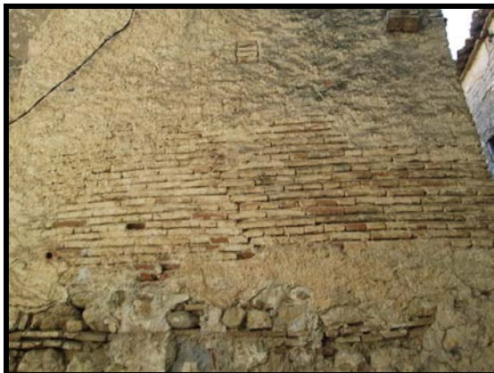
Photo 4.15 : Décollement de l'enduit sur le mur extérieur.
