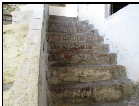
Photo 4.23 : Décollement de l'enduit au niveau de l'escalier.
