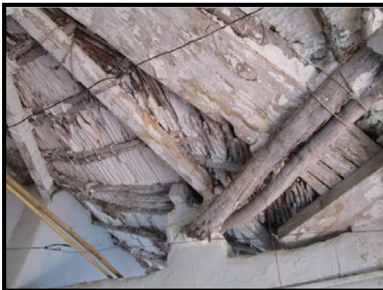
Photo 4.17 : État très avancé de dégradation de la couverture.
