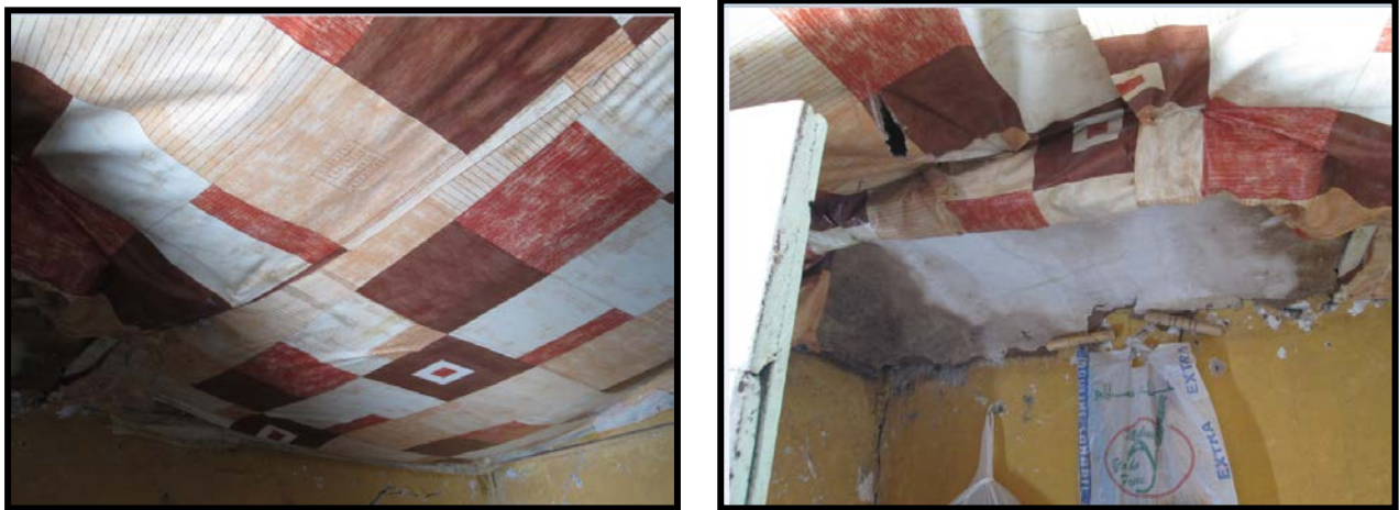
Photo 4.19 : Effondrement totale et remplacement de la toiture par une toile cirée.
