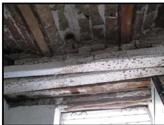
Photo 4.24 : Corrosion des poutres métalliques.
