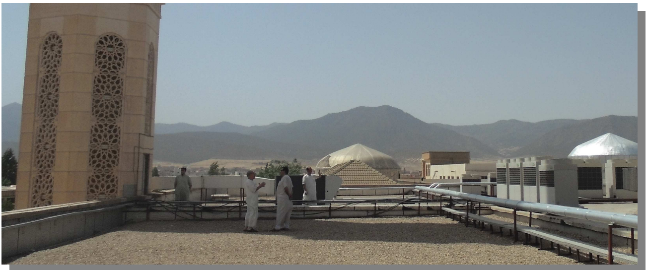
الشكل 10.5: صورة تبرز المحركات الكبيرة لأجهزة التبريد فوق سطح قاعة الصلاة. (المصدر: الكاتب 2012)
