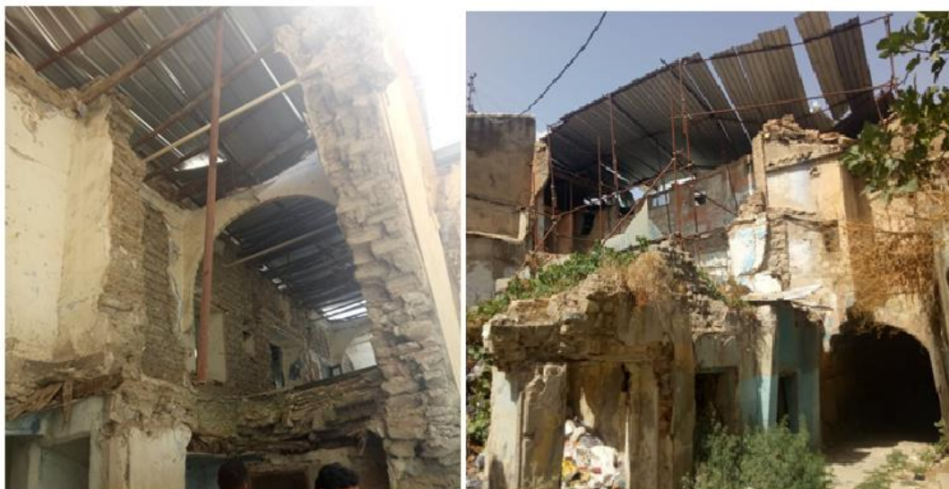
Figure 8.9 Etat de dégradation actuelle de la maison Ibn Badis.
