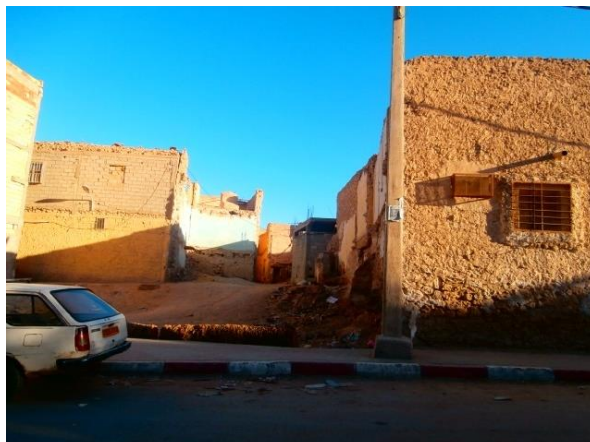
Figure 6.32. dégradation très avancée de quelques maisons dans ksar de Ouargla.
