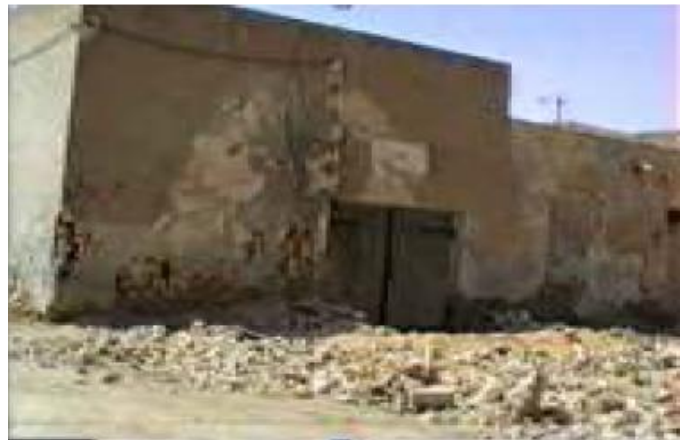
Figure 6.39. Effet de la remontée des eaux sur les soubassements d'une maison ksourienne à Mestaoua.
