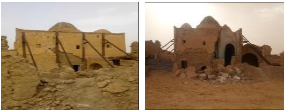
Figure 6.28. La mosquée El kouba El Khadra menacée puis détruite sans aucunes mesures d'urgence.
