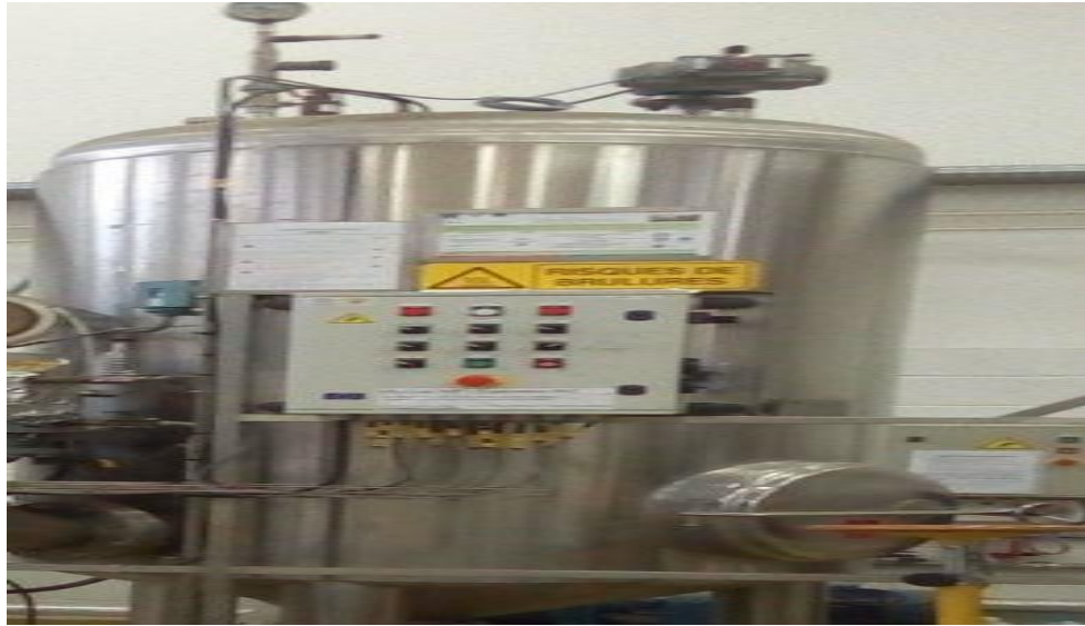
Figure 3.9. Pompe et Réservoir sous vide de la DIC
