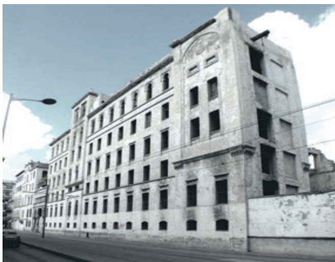
Ancienne Minoterie, Moulins ERRIAD (Ex Narbonne) (1862), l'un des édifices les plus marquants sur la rue tripoli de la commune d'hussein dey. Photo (Auteur, Novembre 2015)
