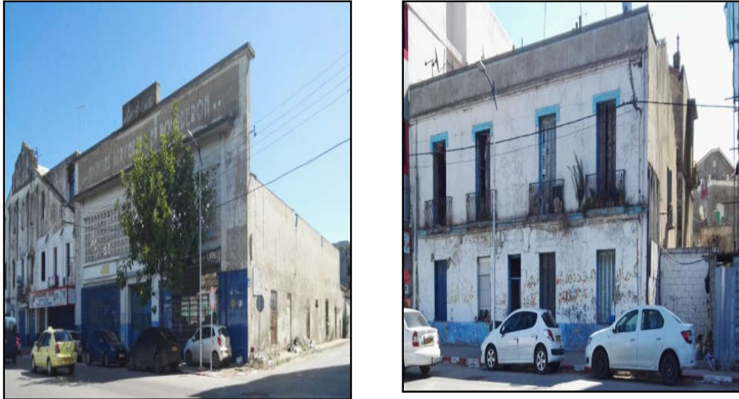
Figures 6.10 : La dégradation des constructions à Annaba
