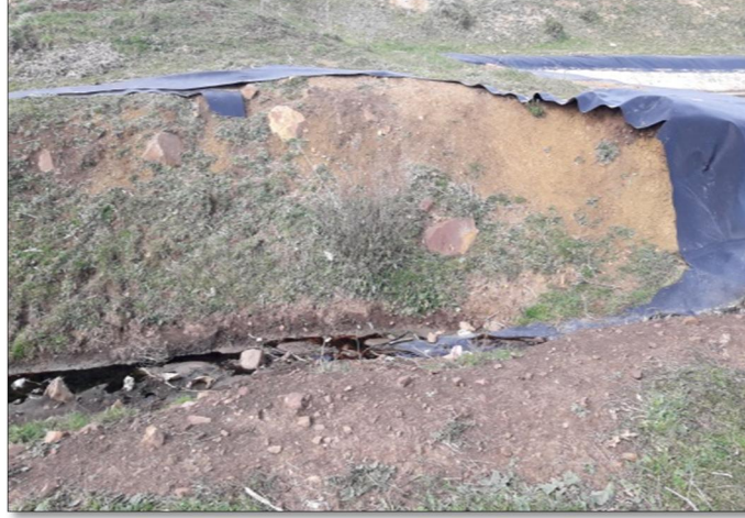
شكل رقم(102): تمزق الغطاء الواقي (géomembran)
