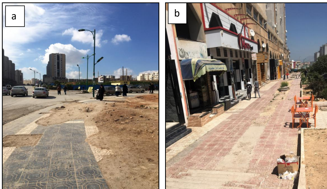
Figure 6.12 (a, b) : Des trottoirs appartenant au boulevard principal dans un état très détérioré. Source : (Auteur, 2018).
