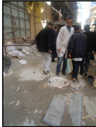
Photo 40 : rue Lannabi Said, Revêtements irréguliers
