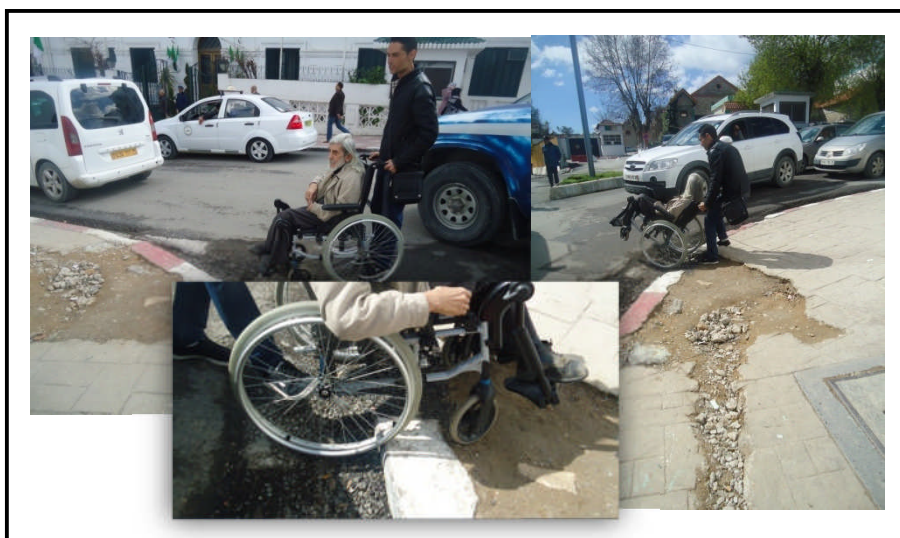
Photos 15 : angle rue John Fitzgerald Kennedy ; trottoir en mauvais état
