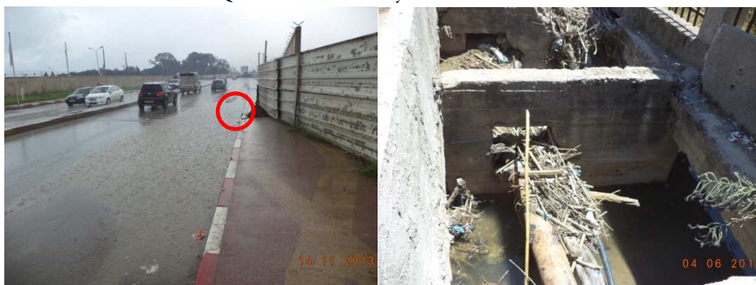
Photo N° 15: Quartier Iriahène : Système d'évacuation défectueux
