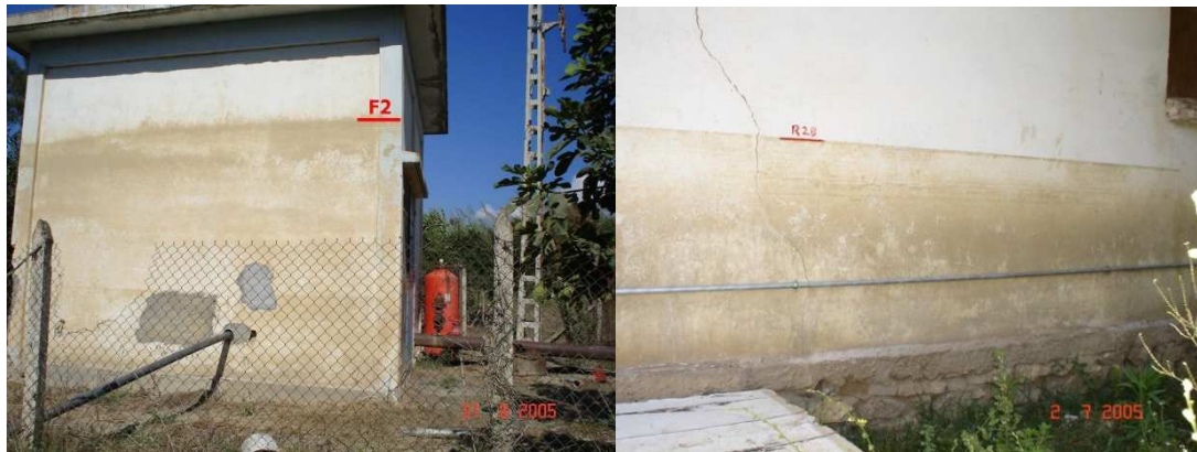
Photo N° 07 : Laisses de crue de décembre 2002
