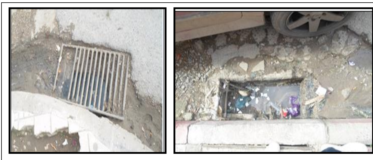
Fig. n°12 : Affaissement de et infiltration des réseaux d'assainissement
