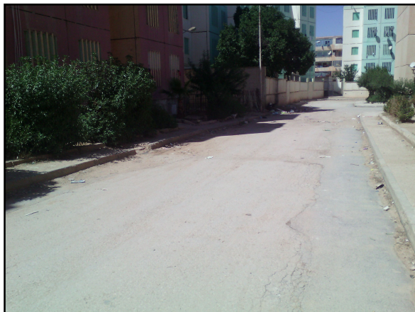
Photo N°40 : Voie recouverte de bitume. (Cité Fatima Zahraâ)
