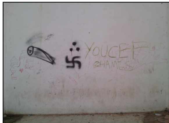
Photo N°86 : Mur tagué et agressivité visuelle dominante (Cité des 580 logements AADL).
