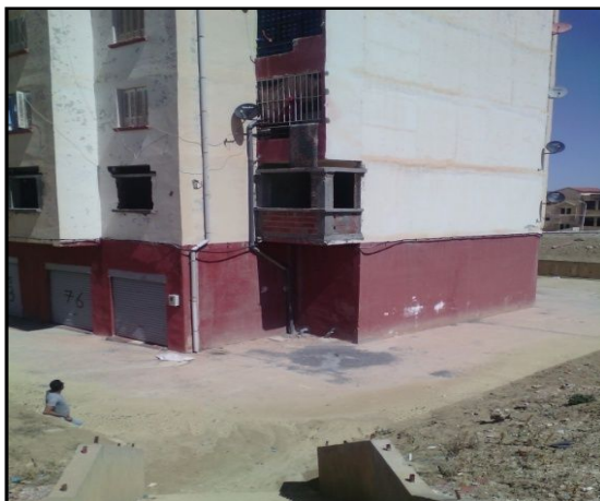
Photo n°35 : La seule intervention sur le balcon. (Cité des 580 logements AADL).
