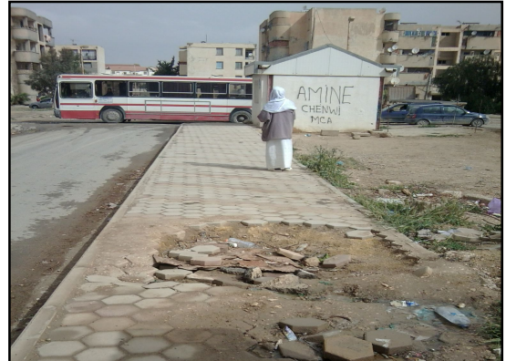
Photo n° 100 : Trottoir détérioré (Cité de Fatima Zahraâ).
