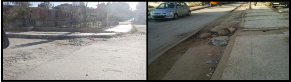
الصور(102-103-104-105):اشغال بدون ترميم واعادة اعتبار
