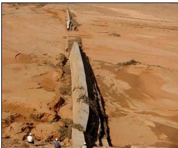
Figure n°20: Destruction du barrage El Haimeur (Photographie : ASAL)
