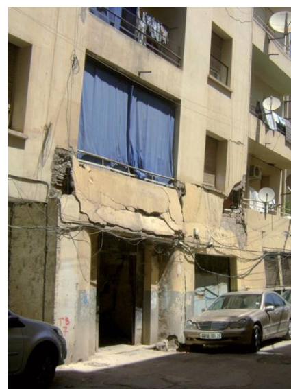
Photo II-10 : construction menaçant ruine sous l'effet de glissement de terrain au centre-ville de Constantine (apparition de larges fissures au niveau de la façade)
