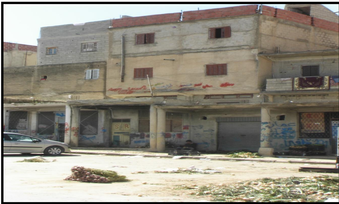
Photo n° 06 : exemple du non respect des normes de l'urbanisme et de la construction à Ain-Beida
