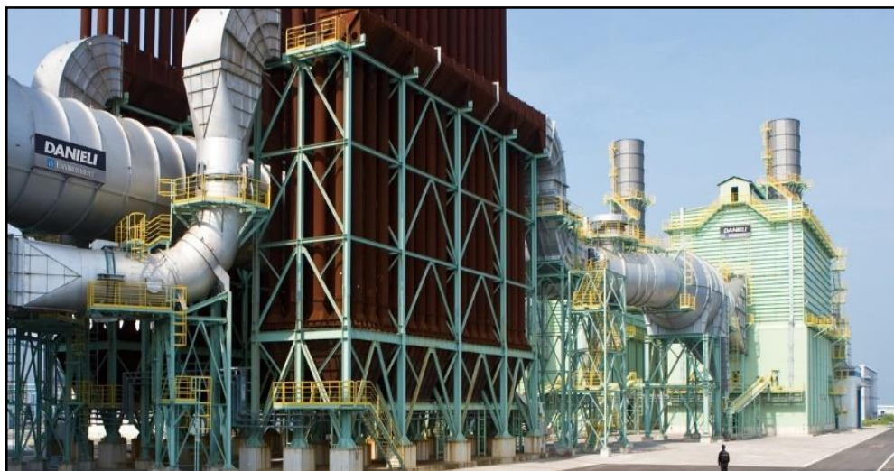
Fig 4.11 : Installation de traitement des fumées (source : AQS)
