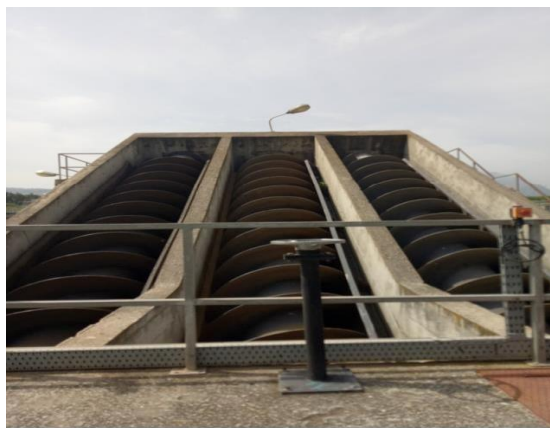
Figure III.9 Pompes à vis de retour de boue[35]
