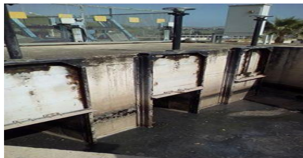
Figure III.3. Canaux d'entrées de l'eau usée au criblage grossier, avec des ouvertures manuelles[37]
