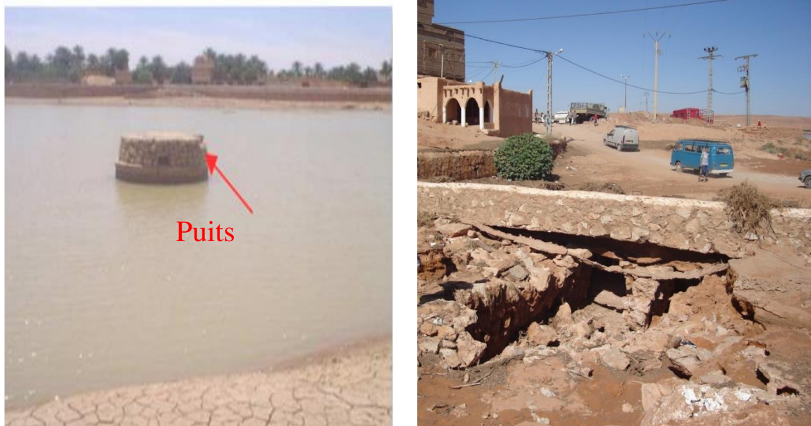
Figure VII. 13: Puits capteur du barrage Bouchène à Ghardaïa à gauche, et le Tissambads détruit à droite par les inondations.
