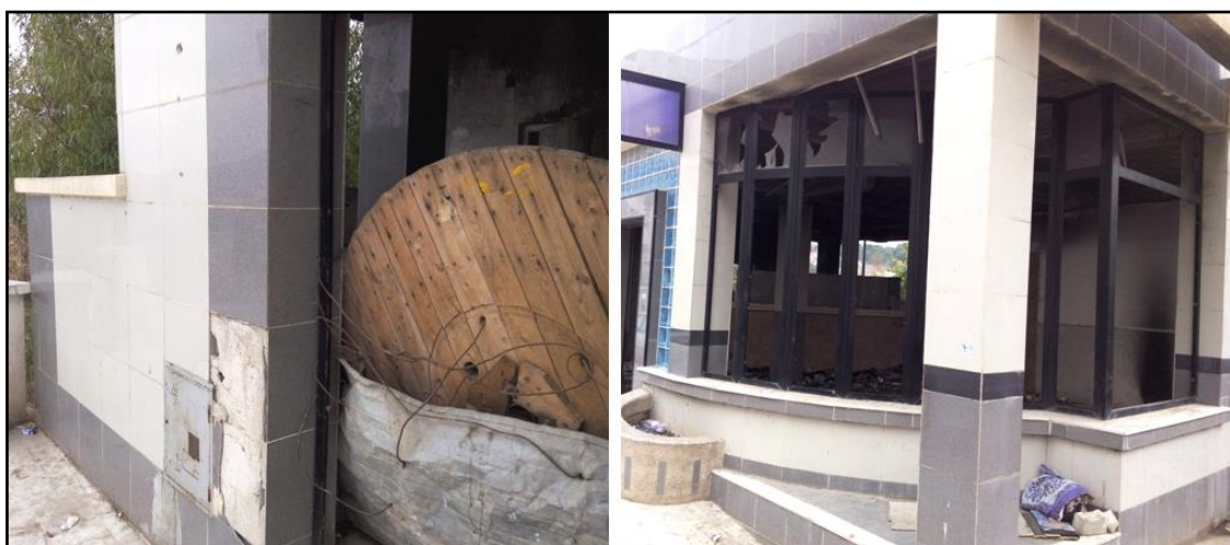
Ph.102, 103: L'état des locaux commerciaux de la place Kerkeri.
