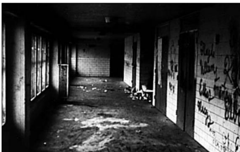
Figure 5 : Le couloir commun du 3ème étage tel qu'il s'est révélé et le vandalisme qui s'ensuivit.
