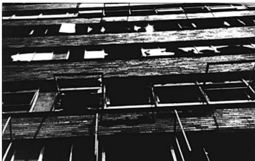
Figure 6 : Vandalisme au grand nombre d'appartements vacants à Pruitt-Igoe vu de l'extérieur. Source : Oscar Newman, 1996
