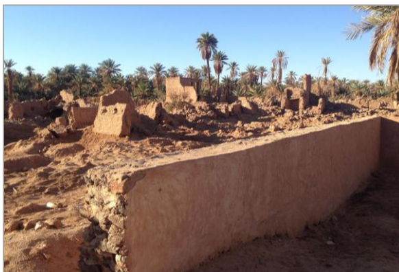
3-Effondrement d'une bonne partie de ksar béni-abbés après une forte inondation.
