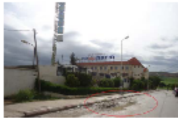
(fig. 4 et 5) : exemple de l'état des VRD dans les deux Zones industrielle Palma , et zone d'activités le Rhumel (Source: Auteur, Avril. 2016)
