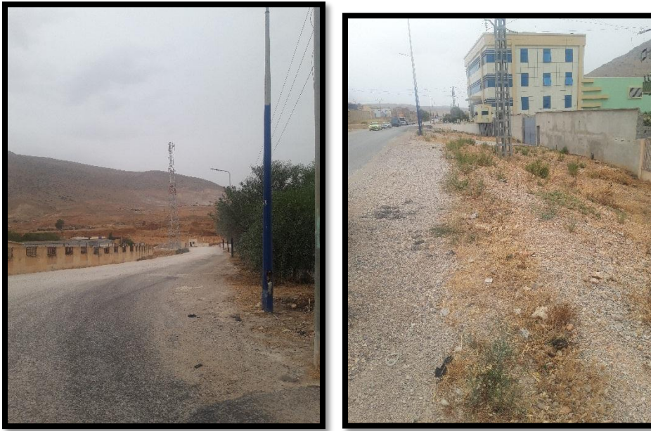
Fig.6.5 et Fig.6.6 : l'état de la voirie de la zone industrielle El Tarf
