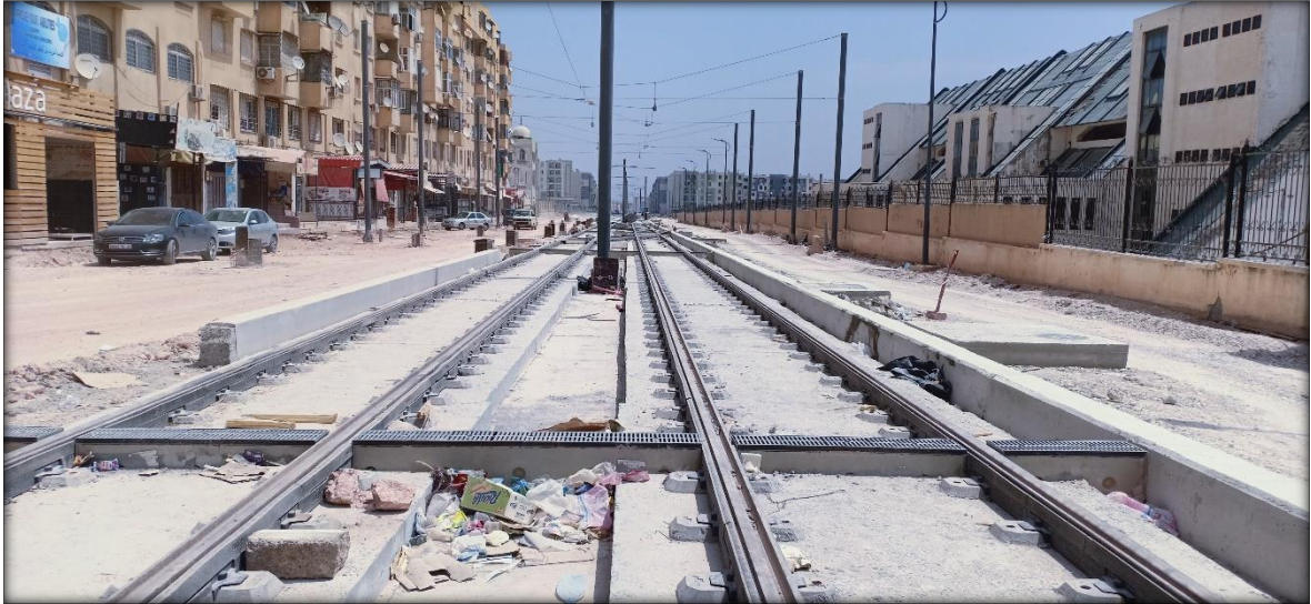
Figure 7.6 désordre alentours du chantier, source : auteur 2019
