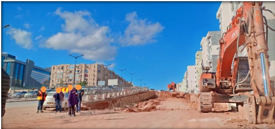
Figure 7.5 absence de clôture dans un endroit d'excavation, source : Auteur 2019
