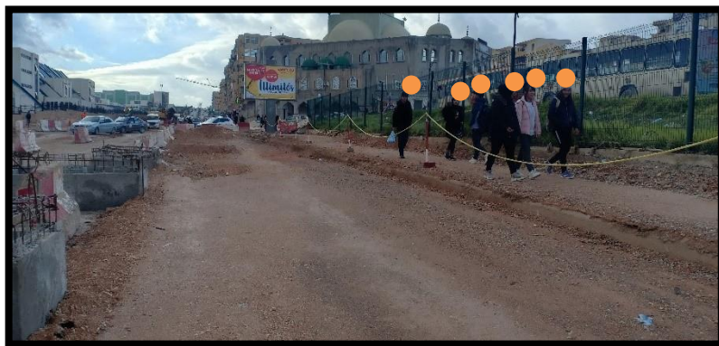
Figure 7.2 dégradation de la chaussée, source : Auteur, 2019
