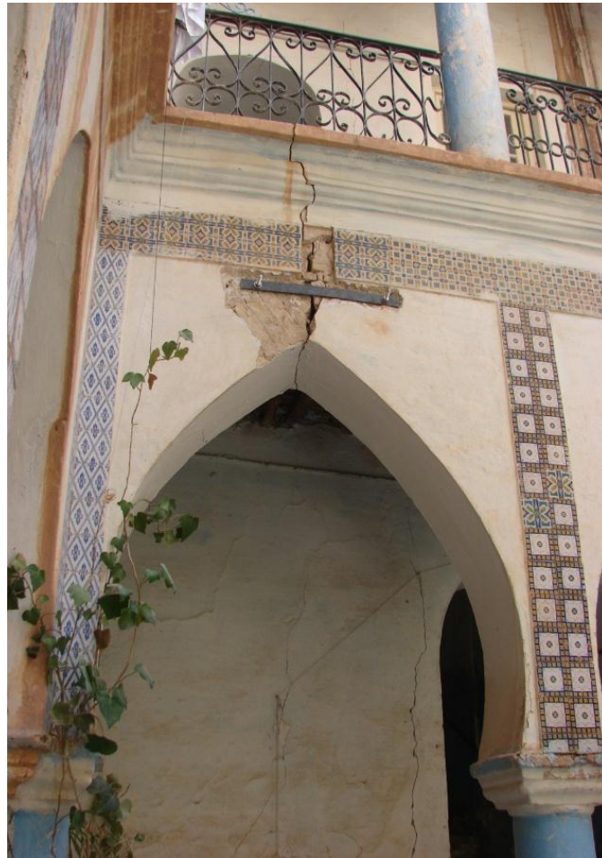
صورة رقم V-38 : ربط شروخات العقد بصفائح معدنية و شدها بقضبان فولاذية المصدر: تصوير الطالب ، (27 أوت 2016)
