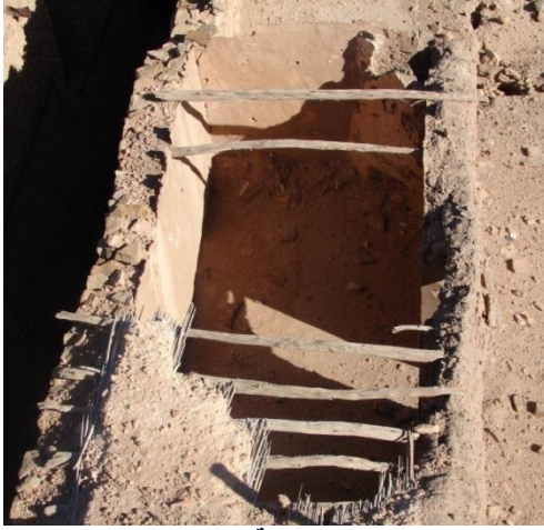
صورة رقم V-15: انهيار سقف بسبب إهمال الصيانة بقصر عين ماضي تصوير الطالب، (10 أمارس 2017)
