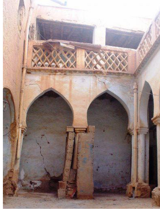
صورة رقم 5- V : تدعيم عمود بمواد بناء غير مناسبة ، منزل بالأغواط ، المصدر : تصوير الطالب ، (06 فيفري 2014)
