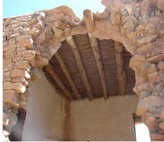
صورة رقم V-14: انهيار جدار مع بقاء العوارض الحاملة للسقف بمنزل بقصر تاويالة، تصوير الطالب، (15 جانفي 2015)
