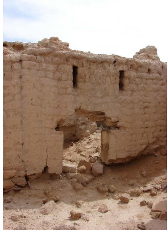
صورة رقم V-1 : نزع أسكاف باب خشبي لمنزل بقصر تاجرونة المصدر : تصوير الطالب، (02 جانفي 2015)
