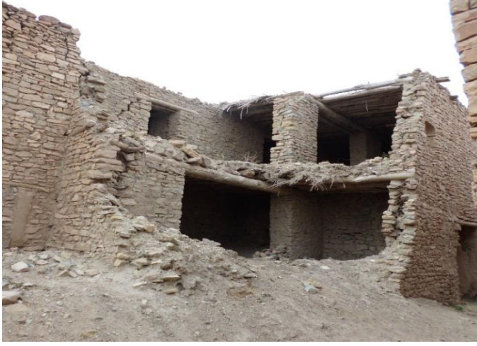
صورة رقم VI-2 : مبنى في حالة تقنية سيئة جدا ، تصوير الطالب (16سبتمبر 2016)
