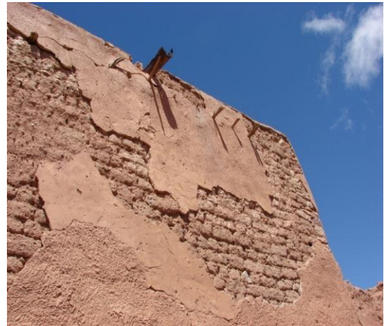
صورة رقم V-16: تساقط التغطيات عن جدران المبنى بقصر الحويطة المصدر : تصوير الطالب ، (17 أفريل 2018)
