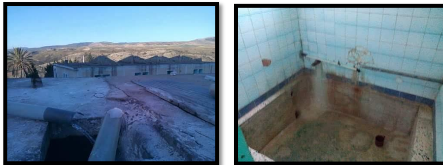
Photos 5.28 État des lieux du Hammam Guerfa.
