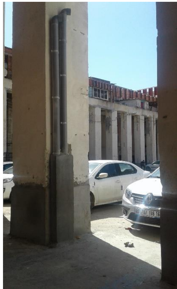
Figure IV.18. Conduites d'aération adossées à un pilier · place des deux cent colonnes · Climat de France · Alger.
