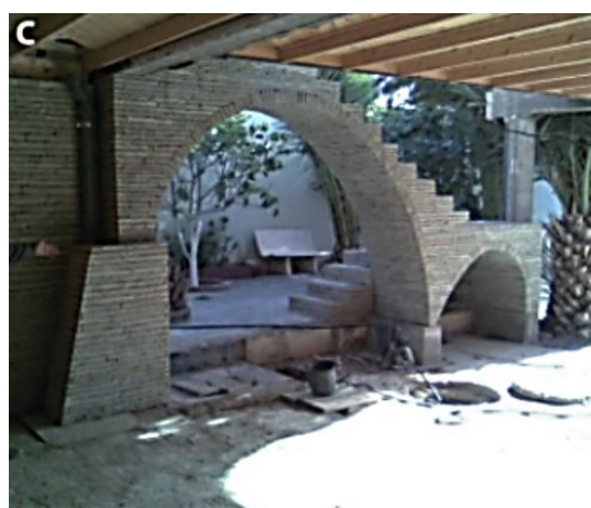
Figure VII.2. Abdelhamid Si Larbi, habitation sur la corniche oranaise, 2013-20??, disposition de la pierre du mur favorisant le travail à la compression.
