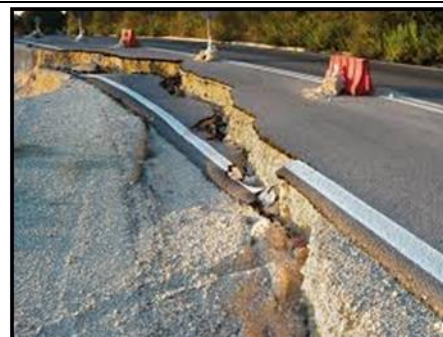
Photo 21. Dégradation physique des voiries. Source : Saadaoui, 2018
