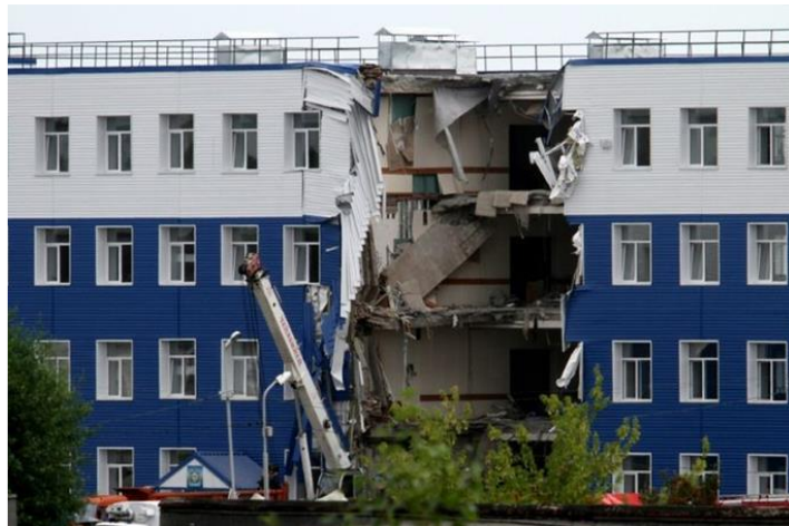
Photo 8. L'effondrement d'un bâtiment militaire en 2015.
