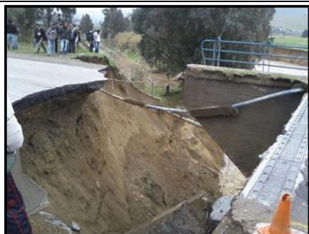
Photo 20. Impact du glissement sur les ponts. Source : Saadaoui, 2018
