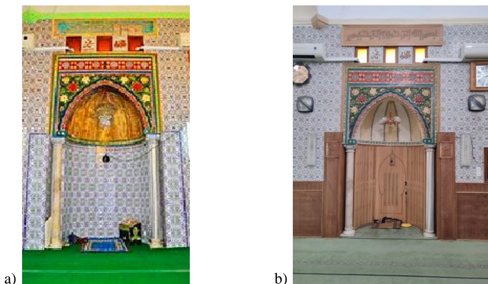
Figure 4.15. Changement du revêtement du Mihrab et du soubassement des murs après les travaux de restauration en 2000 : a) avant (Source : Benbella, Kh, 2008), b) après. (Source : Auteur, 2023)
