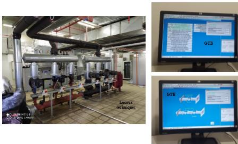
Figure 5.26 : Locaux techniques et système informatisé pour la gestion technique du Cyberparc et du CIC. Source : Auteur, 2022
