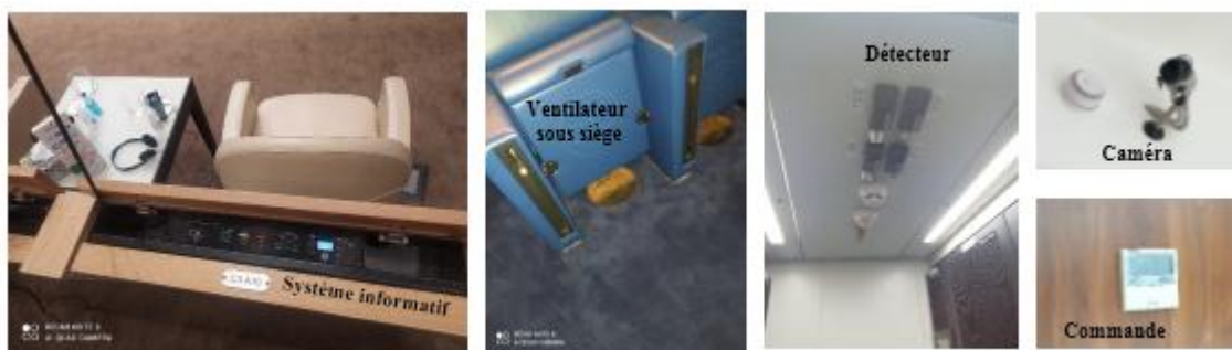
Figure 5.27 : Images démontrant quelques systèmes d'information, de communication, de sécurité et de surveillance utilisés au Cyberparc et CIC. Source : Auteur, 2022
