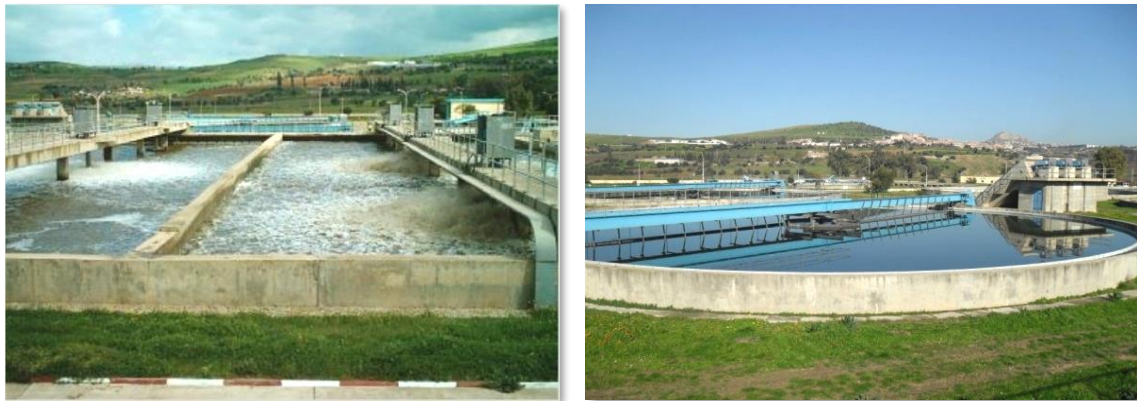
Figure III.09 : Station d'épuration de boues activées d' IBN ZIAD , Algérie.
